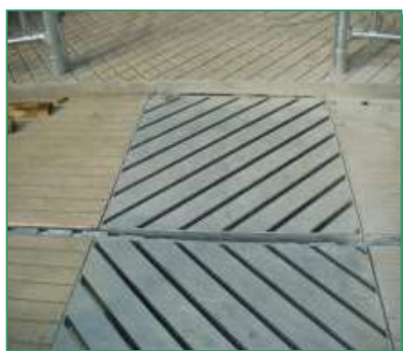
Středový kanál s ocelovým roštem
