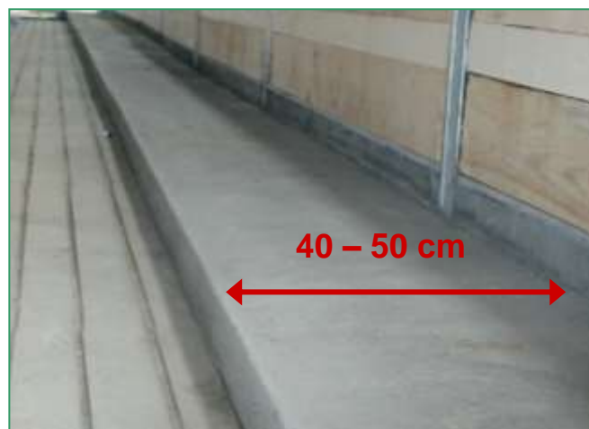
Předpožlabnicový schůdek je důležitým stavebním prvkem stájového designu
