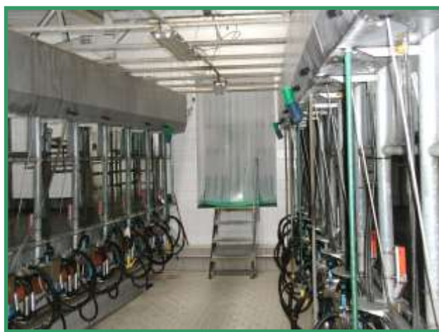
Řada zářivkových těles je situována v ose chodby, osvětlení je nedostatečné
