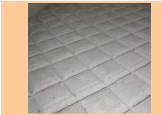
Nesprávná profilace betonové podlahy v pohybových chodbách tzv. „buchtý“
