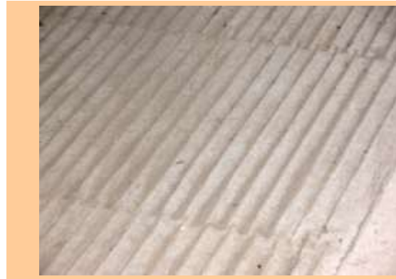
Nesprávná profilace betonové podlahy na hnojných chodbách
